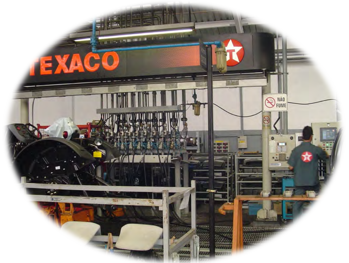
Sistema de Abastecimento de Tratores Valtra – Mogi das Cruzes & Santa Rosa
