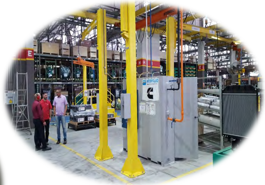
Sistema de Abastecimento de Geradores - Cummins
