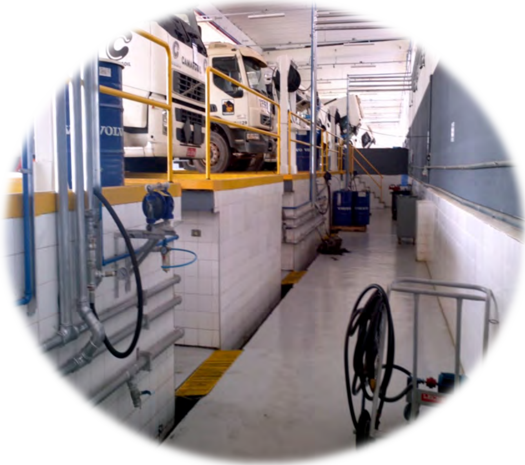
Sistema de Abastecimento de Caminhões Volvo Auto Sueco – Limeira & Barueri
