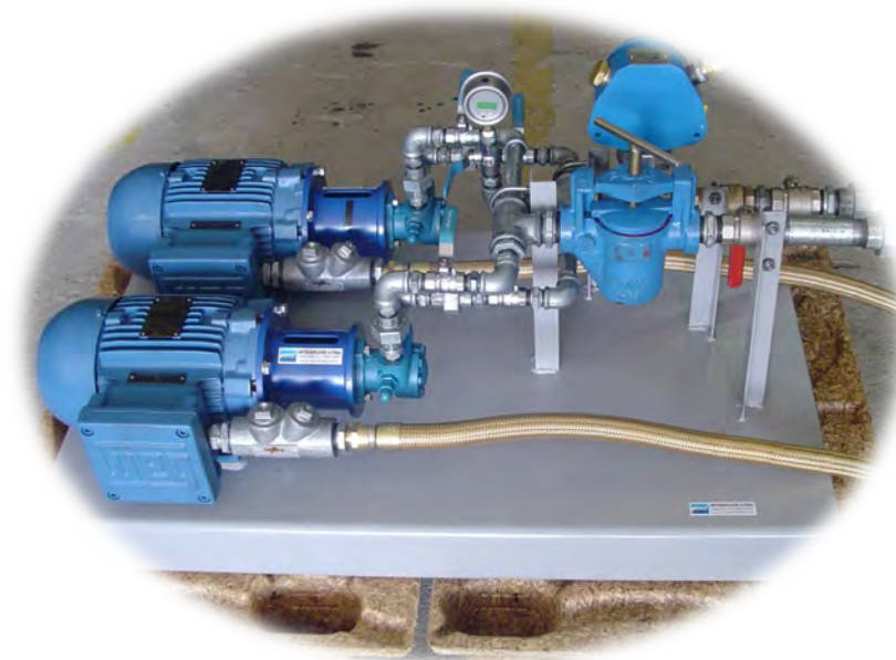
Sistema de Injeção de Silicone em Plataformas Offshore – Dow Sudeste
