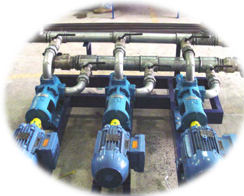
Sistema de Abastecimento Combustíveis COSIPA
